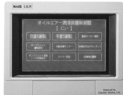
図6 コントロールパネル Control panel
