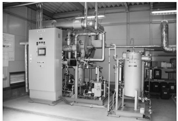
改善事例 (廃液蒸発濃縮装置)
