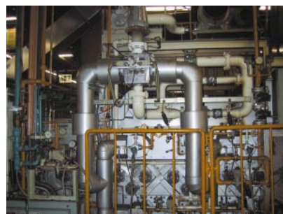
国分工場のリジェネバーナ導入連続炉
