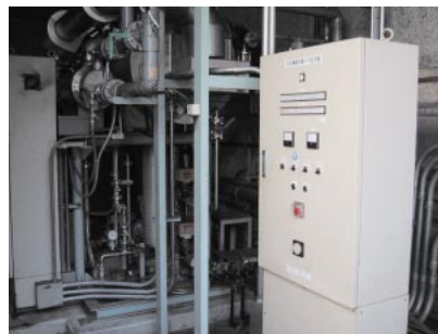
図6 廃液濃縮処理装置
